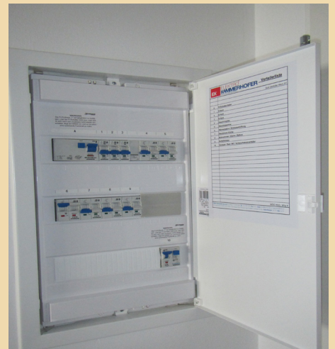
Verteiler mit Sicherungsautomaten
