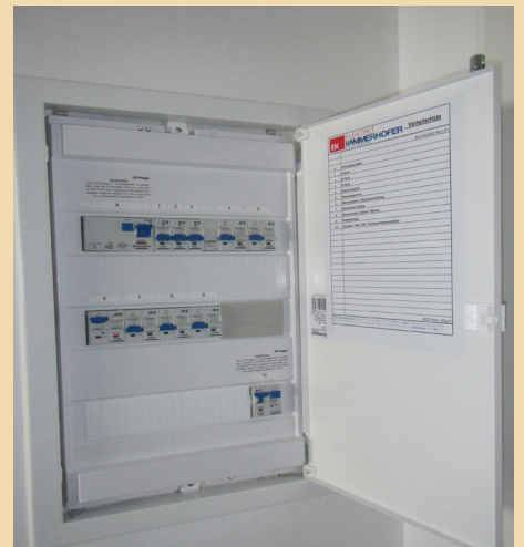
Verteiler mit Sicherungsautomaten
