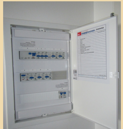
Verteiler mit Sicherungsautomaten
