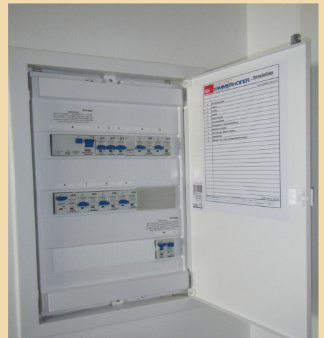
Verteiler mit Sicherungsautomaten
