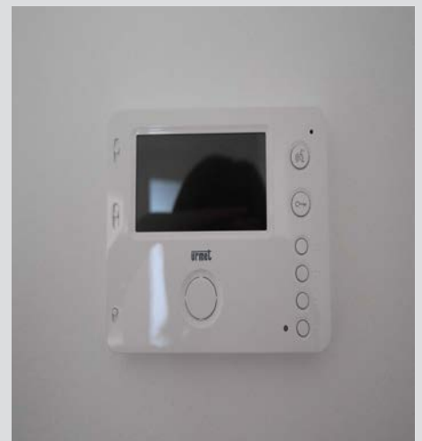
Gegensprechanlage mit Videoüberwachung und Türöffner
