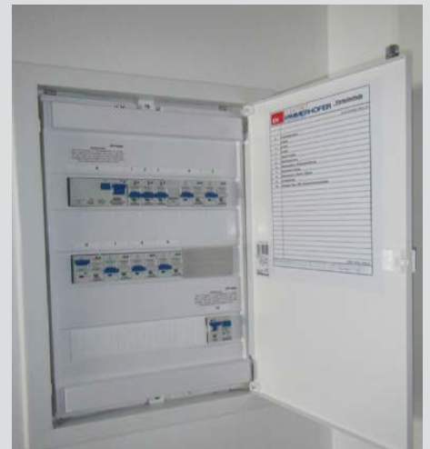
Wohnungsunterverteiler mit Sicherungsautomaten
